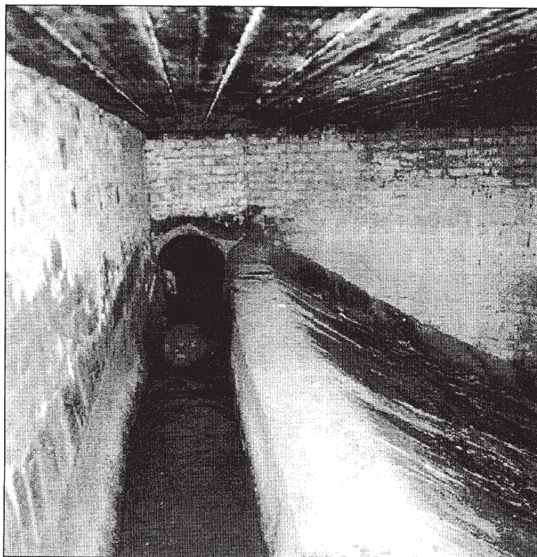
Figura 6: Manufatto scolmatore presente nella rete di fognatura di Bologna
